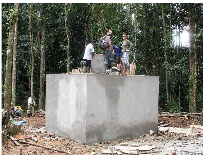
Illustration 114 – Réservoir alimentant le village de Villa Flor (11-9-2007).
